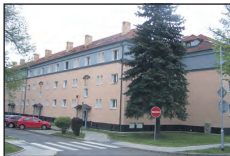
U tohoto rohového domu v ulicích Hornická – 9. května došlo k úplnému ucpání odpadního potrubí.
