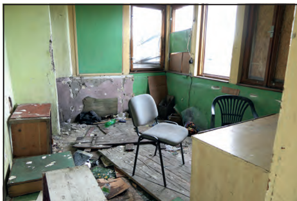
Interiér stavědla ST 1 ze dne 14. listopadu 2020, poté, co bylo již šest let nefunkční. Obsluha stavědel byla ukončena v srpnu 2014.
